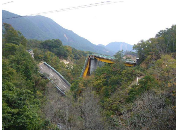
図2 旧国道342号線橋の崩落
