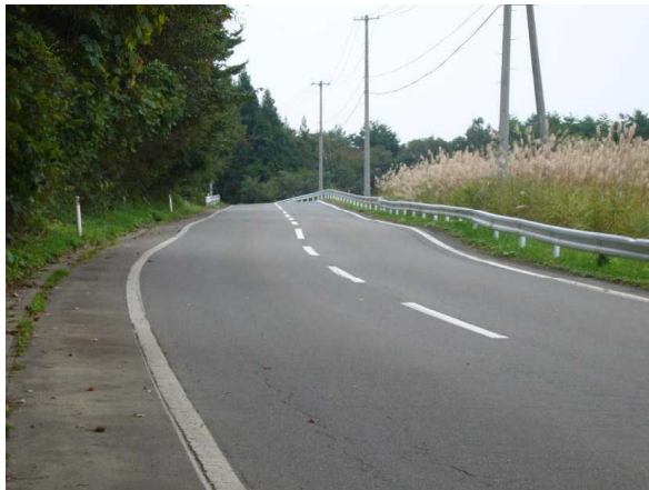
図1 餅転地区断層による道路の歪み (補修後)
