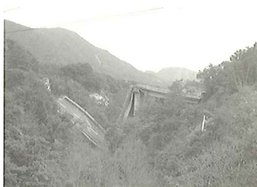
図3 2008年岩手宮城内陸地震における橋の崩落(推定震度6強以上)
