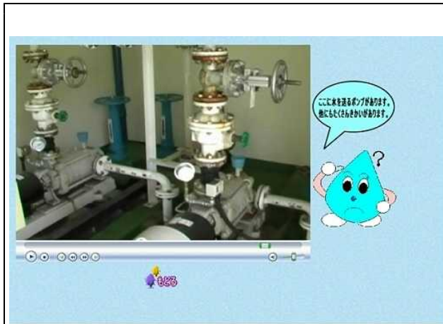
ポンプ室の機械を映したビデオ映像を表示
