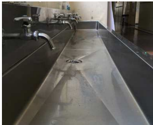
手洗い場の傾きと排水口
