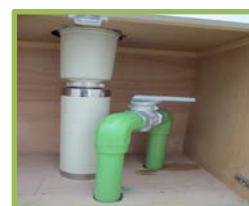
【床などのガス栓】
