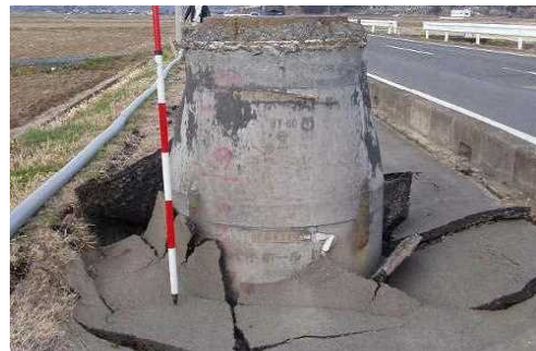
マンホールの浮き上がり 常陸太田市(気象庁HPより)
