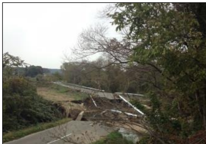
H25年8月の台風被害による道路の陥没
