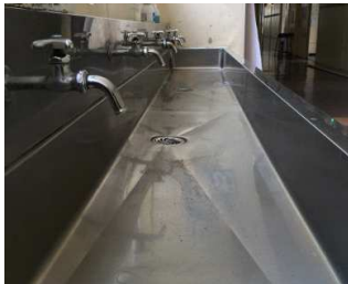
手洗い場の傾きと排水口
