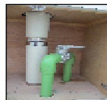
【床などのガス栓】
