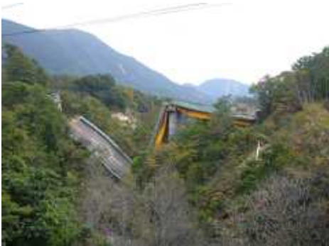
図2 2008年岩手宮城内陸地震における橋の崩落(推定震度6強以上)
