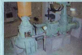
主ポンプ設備
