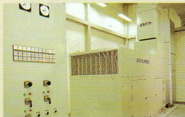
非常用電源設備
